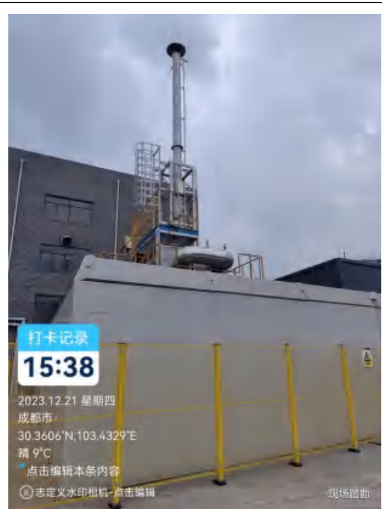
沼气发电机排气筒
